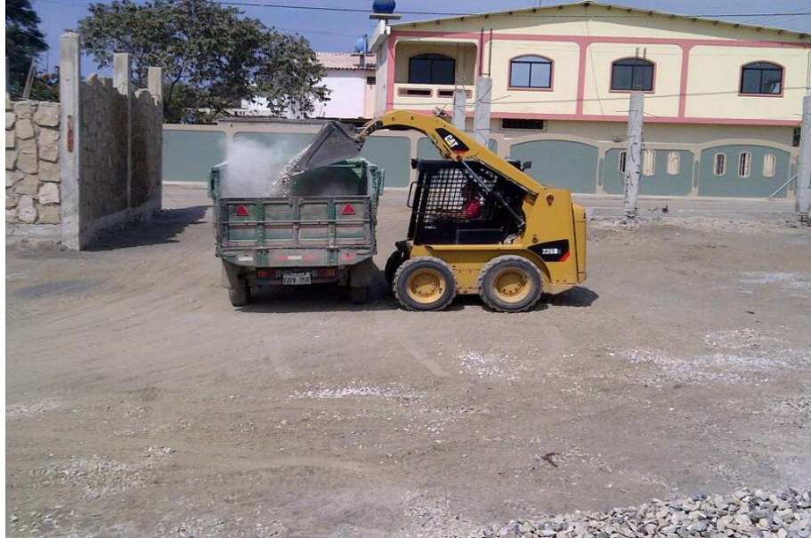
Fuente: Maquinaria de la Empresa Bloques EJR Elaborado por: Isabel Floreano Tomalá
