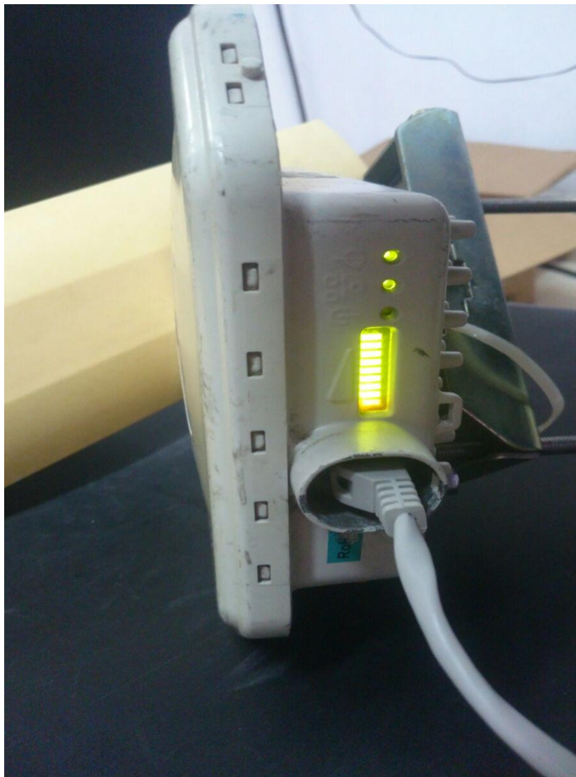
Figura 26 Indicador de señal de los equipos instalados Wimax
