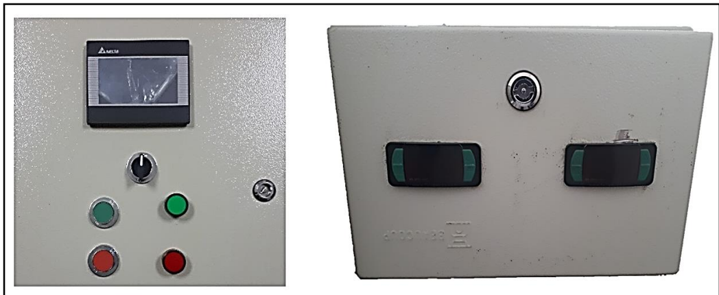
figura 39. Sistema de monitoreo con HMI Delta y HMI VX-950
