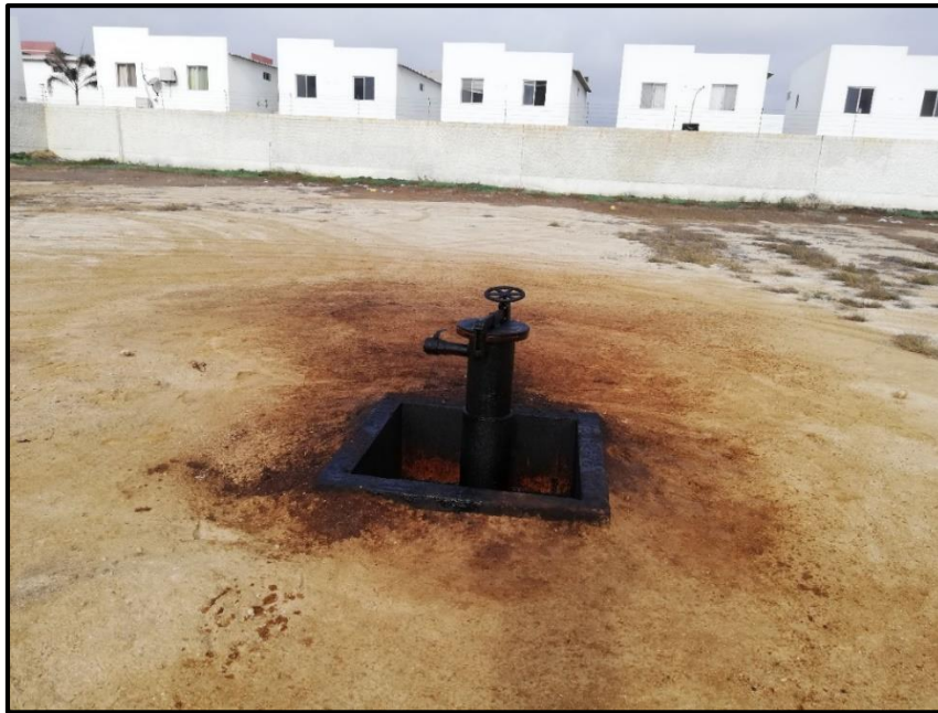
Figura 44. Pozo VA 10 con suelo contaminado por petróleo.
