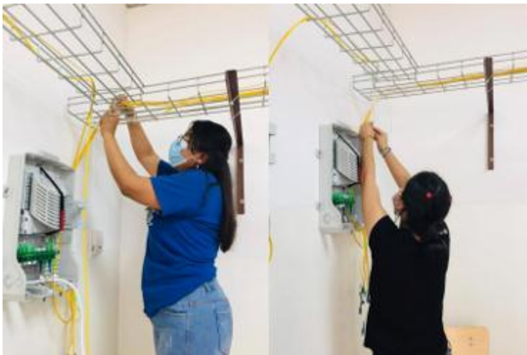
Figura 79. Paso de patchcord de ODF-FDB
