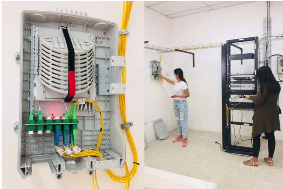
Figura 97. Prueba de continuidad en patchcords
