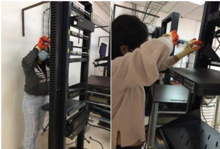
Figura 78. Alojamiento de equipos al rack
