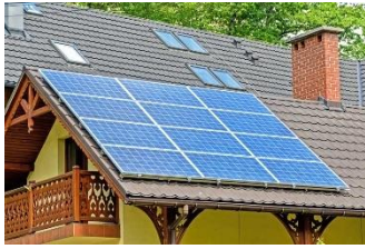
Figura 1: Paneles solares domésticos
