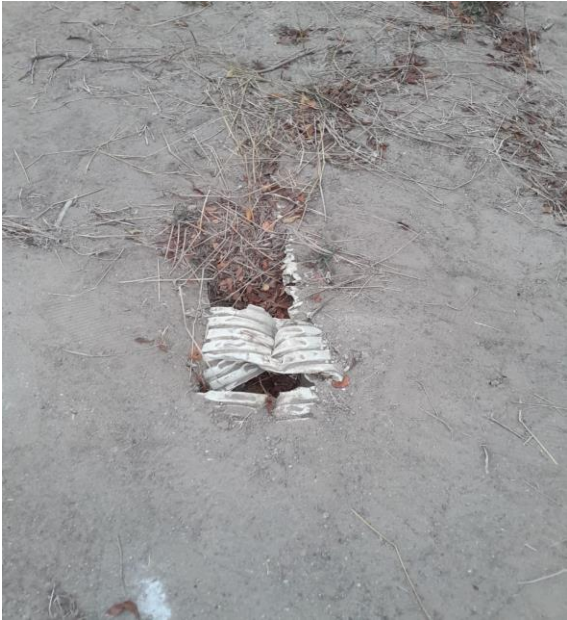
Tubería de alcantarillado pluvial con daños
