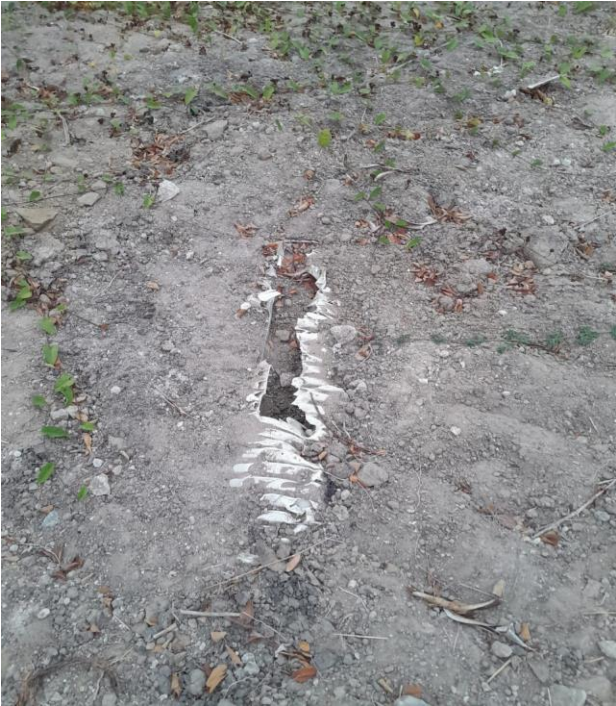
Tubería de alcantarillado pluvial con daños
