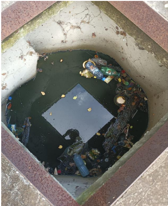
Cámaras del sistema de alcantarillado pluvial con residuos
