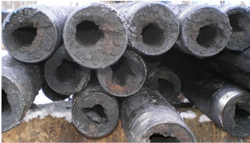
Figura 12. Reducción del diámetro de tuberías debido a precipitación de asfaltenos y parafinas
