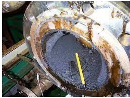
Figura 2. Presencia de capa de asfalteno en el ID de una tubería de circulación.
