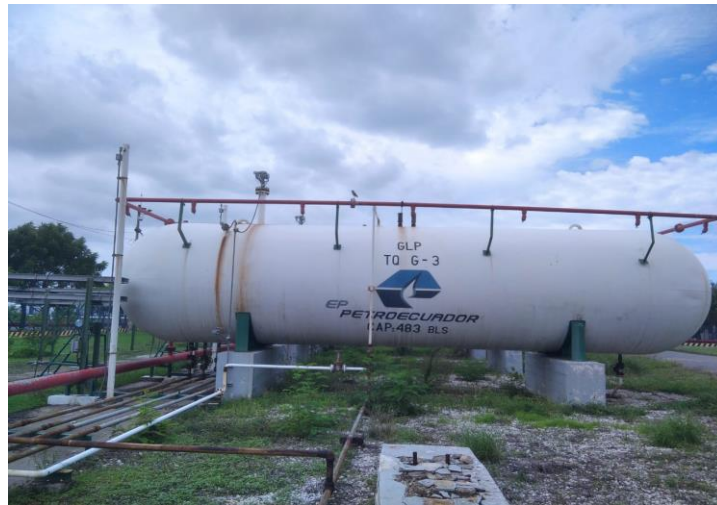
Tanque de almacenamiento TQ-G3
