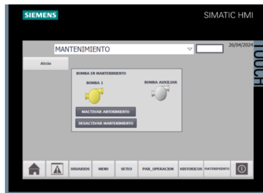
FIGURA 30: Control de estado de manteniendo
