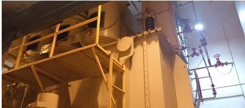
Figura 5: Transformador de Potencia Paute Molino 13,8/138 kV 127 MVA
