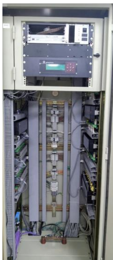
Figura 30: RTU comunicación con servidores POWER ON
