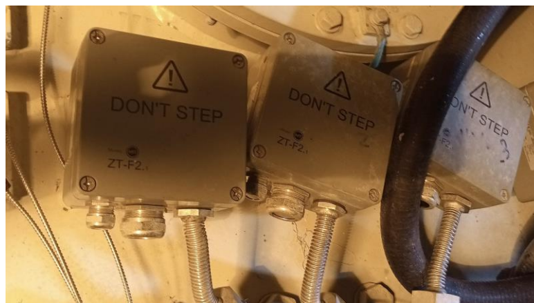
Fuente: Transformador U4, CELEC SUR, Molino Fase AB.
