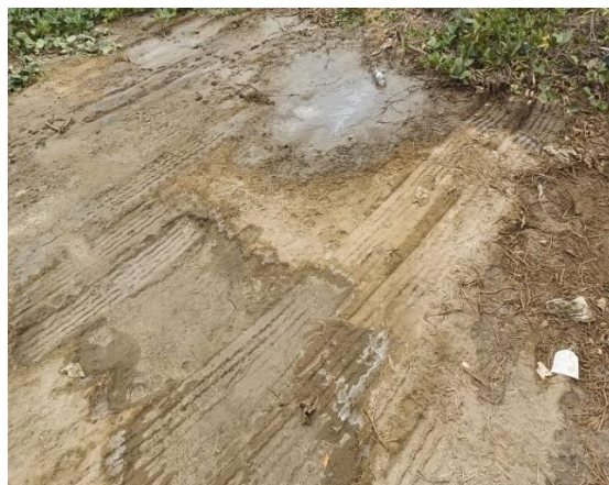
B. Aguas residuales al aire libre
