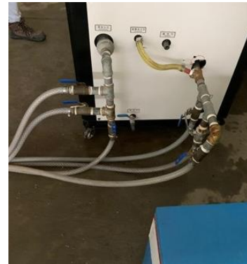
Imagen 6. Mangueras de circulación de agua refrigerada
