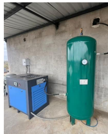
Imagen 10. Compresor de tornillo.
