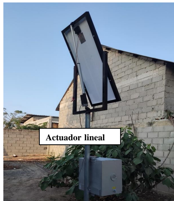
Figura 46. Panel solar en la estructura
