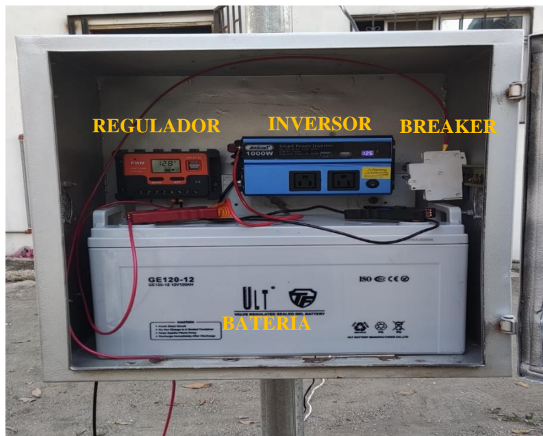
Figura 53. Tablero de conexiones
