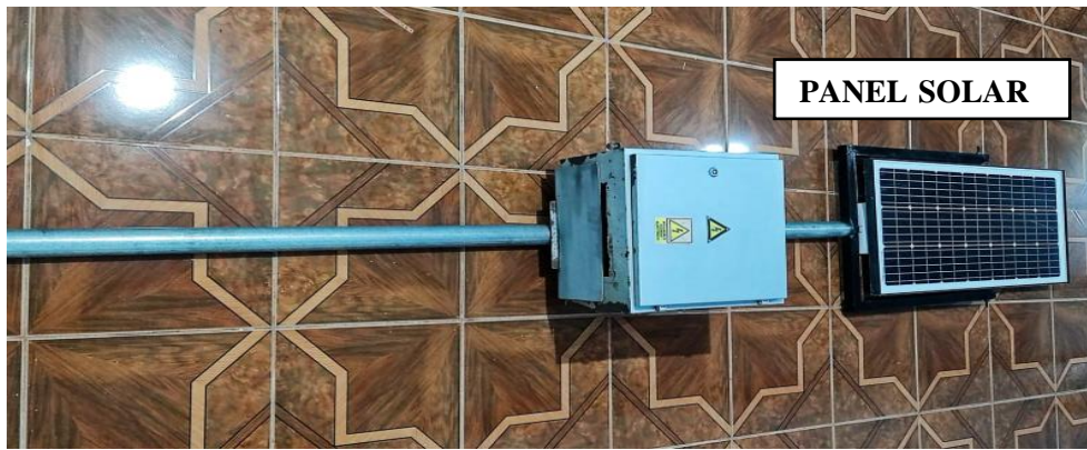
Figura 45. Panel solar en la estructura
