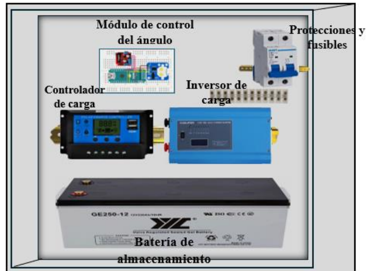
Figura 39. Interior del tablero eléctrico
