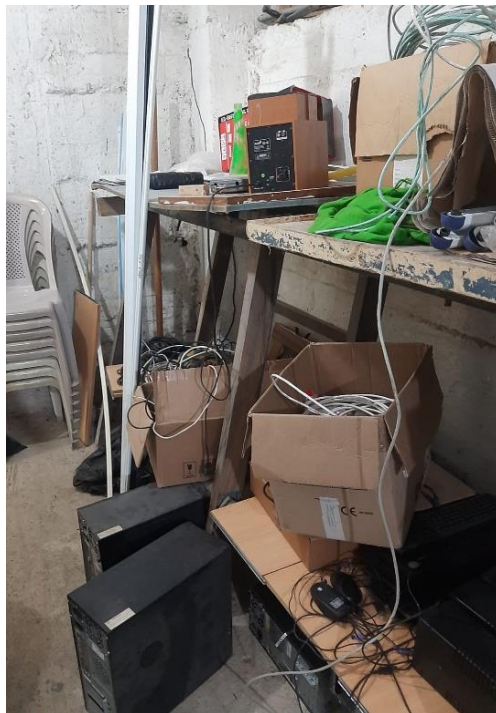
Ilustración 4 Mal almacenamiento de cables, gabinetes y periféricos
