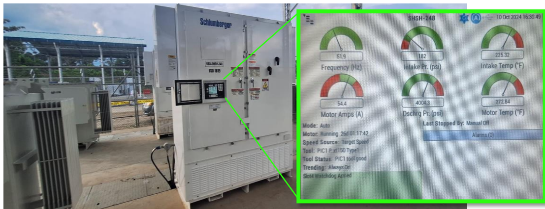
Figura 20 Variador de velocidad (VSD)
