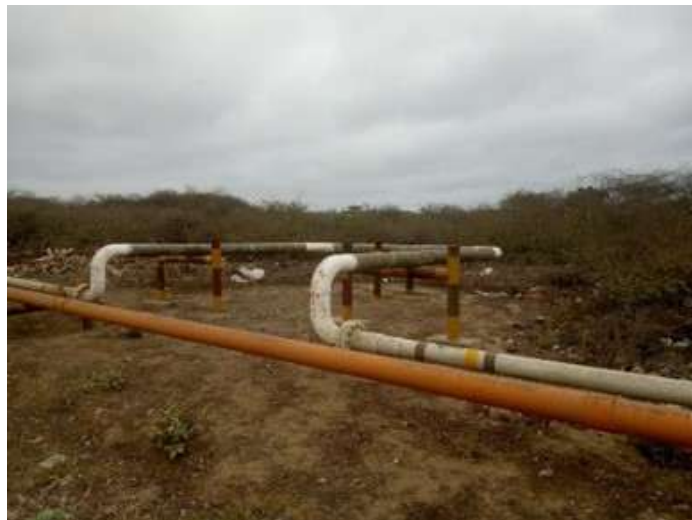
Figura 20. Barrio Cumbres de La Libertad. Nota: los poliductos se encuentran expuestos. Existen viviendas habitadas en las cercanías.
