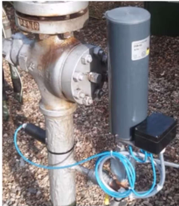
Figura 10. Imagen de una instalación típica del sensor en un baipás. Tomado de (Marino et al., 2022)
