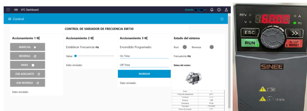
Figura 76. Monitoreo y control de variador de frecuencia por interfaz remota. Fuente: Autoría Propia.
