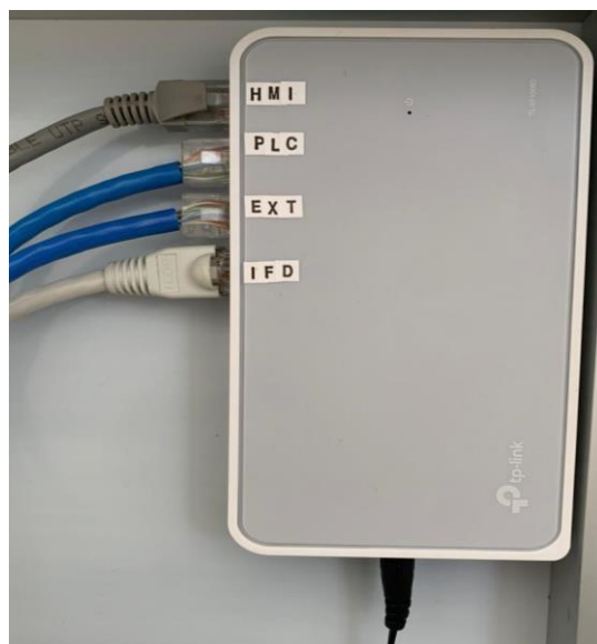
Figura 49. Conexión de puertos del switch TP-Link. Fuente: [24].
