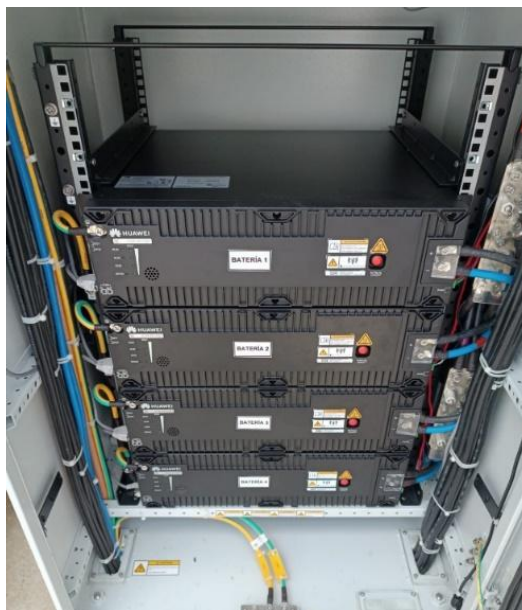
Figura 10. Banco de baterías HUAWEI.
