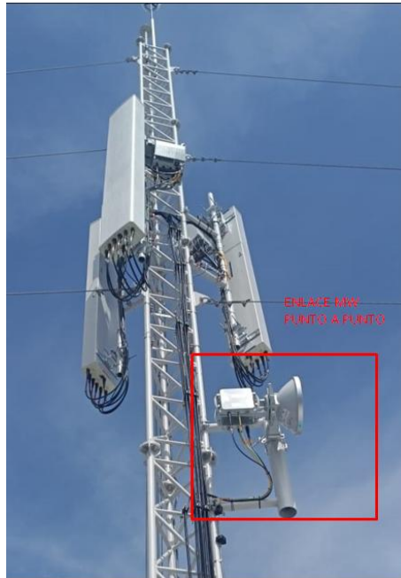
Figura 16. Antena Microonda Huawei.
