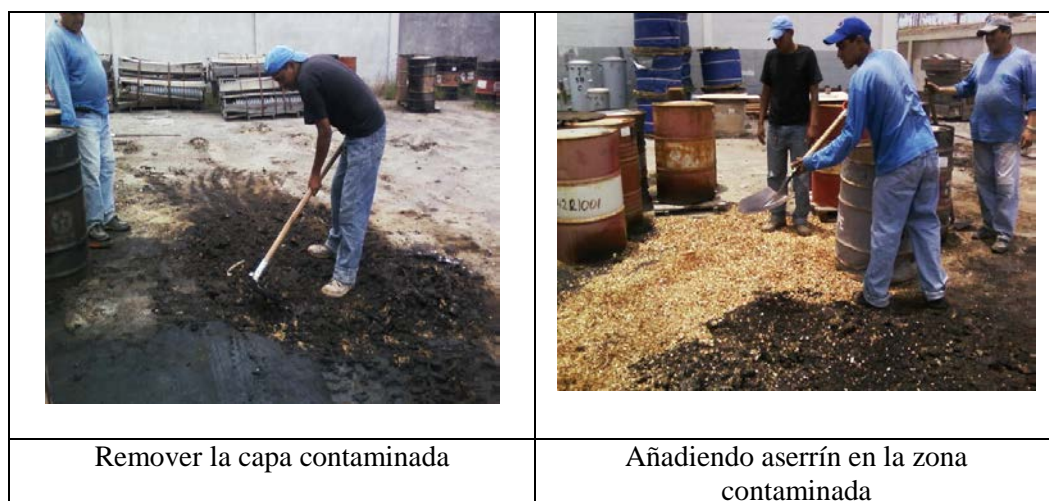
Imagen N° 14.- Limpieza de Aceite Derramado
