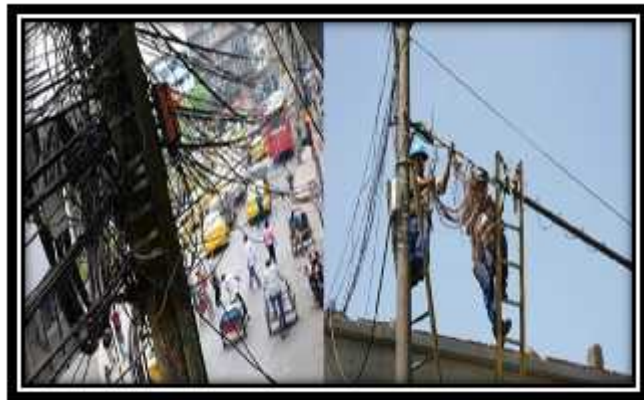
IMAGEN N° 5 MANEJO ELÉCTRICO INADECUADO
