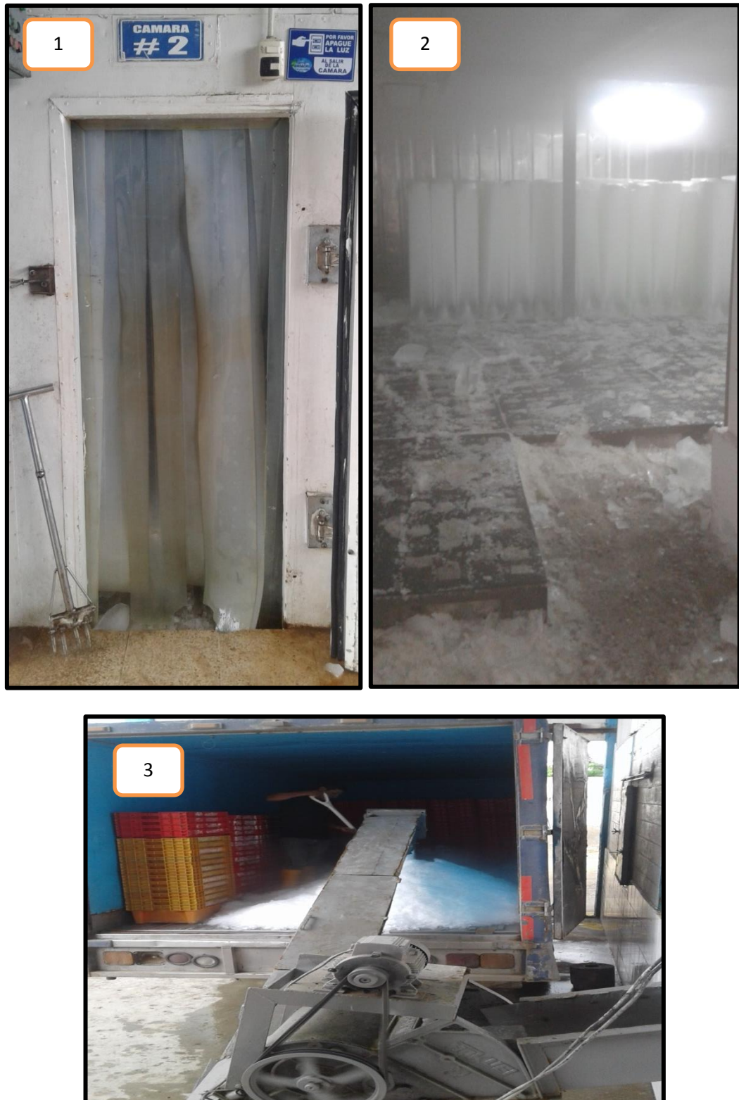
1.- Cámara de frío; 2.- Marquetas de hielo; 3.- Triturador.
