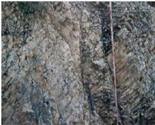
Cuarcitas ordovícicas. Calidad mala. Macizo alterado y brechificado.
