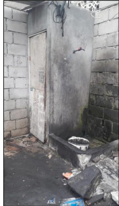
Imagen No. 6 Baños en deterioro
