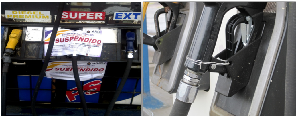
Figura 7. Manguera suspendida por encontrarse fuera de especificación Fuente: Estación de Servicio Coechan
