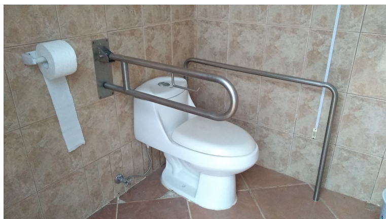
Figura 17. Bateria sanitaria para personas con capacidades diferentes Fuente: Estación de Servicio Ballenita
