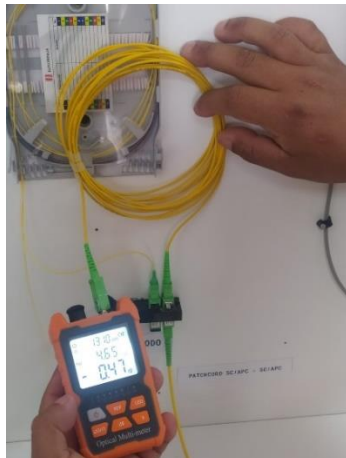
Medición de cables Patch cord 1.
