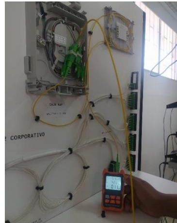
Medición de cables Patch cord 2.
