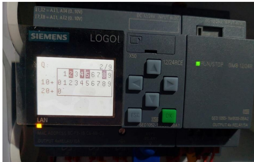
Figura 121. Activación de las salidas Q2,4,5 correspondientes a la bomba 2 y electroválvula 2 y 3.
