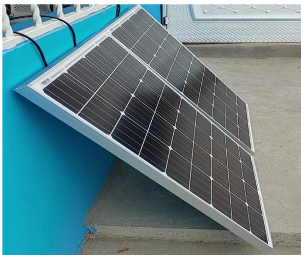
Figura 112. Paneles solares sin mecanismo de seguimiento solar.
