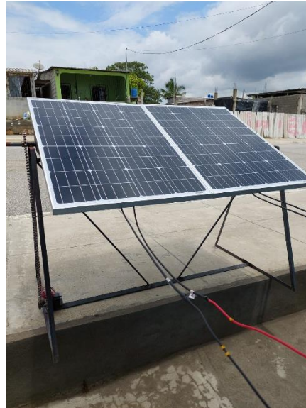
Figura 103. Módulo fotovoltaico expuesto a condiciones ambientales favorables de irradiación solar.
