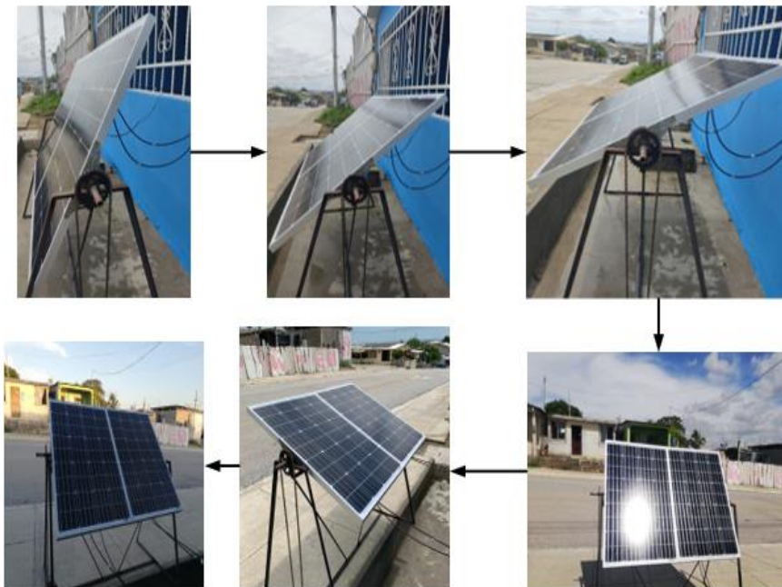
Figura 108. Seguidor solar en funcionamiento durante un día.
