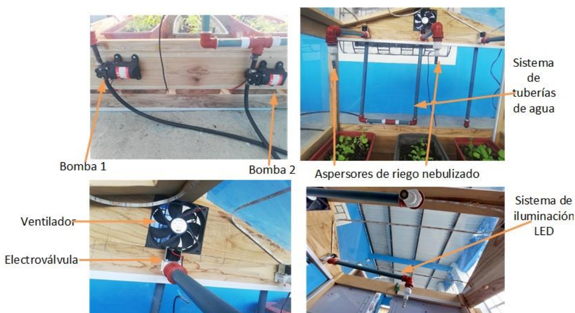
Figura 94. Actuadores eléctricos instalados en la estructura del prototipo invernadero.
