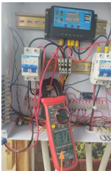
Corriente que se extrae del módulo fotovoltaico
