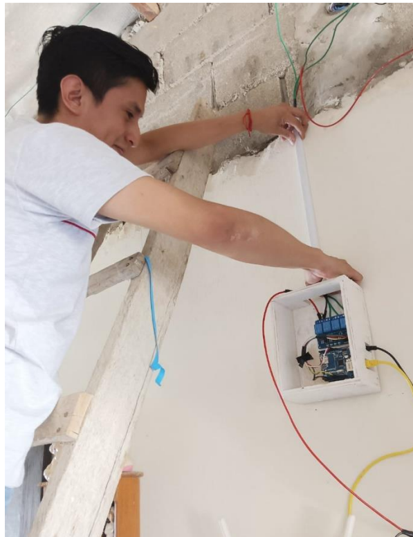
Figura 45: Sistema de control de luces
