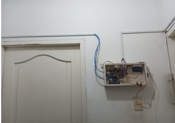
Figura 46: Sistema de control de luces
