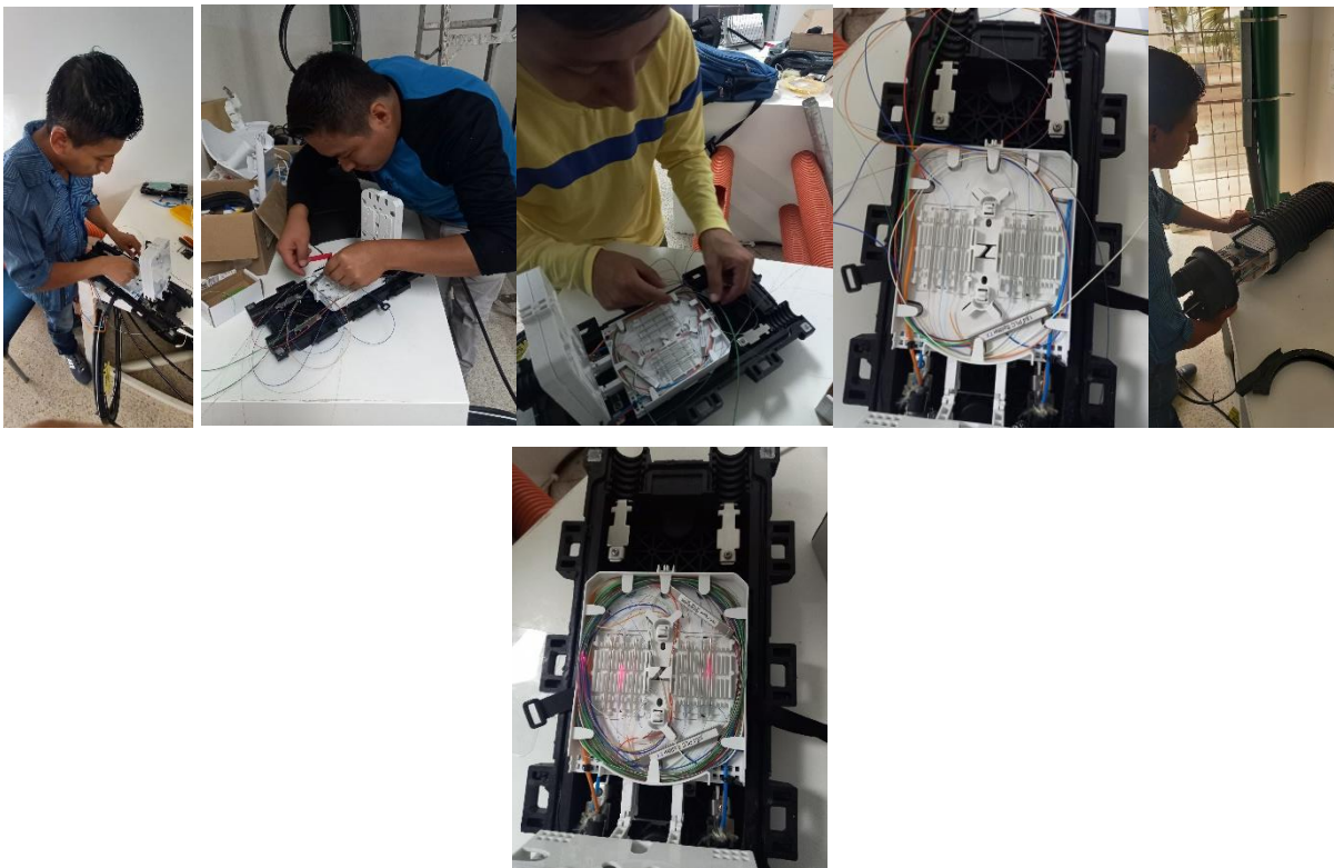
Anexo 5. Colocación y armado de mangas – distribución y primer nivel de spliteo.
