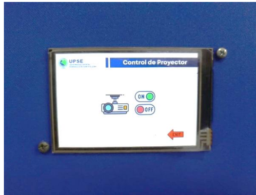
Figura 48. Estado de encendido del proyector.
