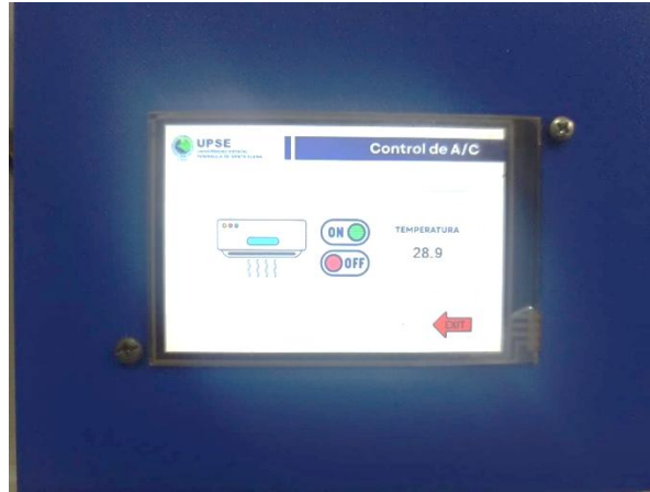
Figura 46. Estado encendido del aire acondicionado.
