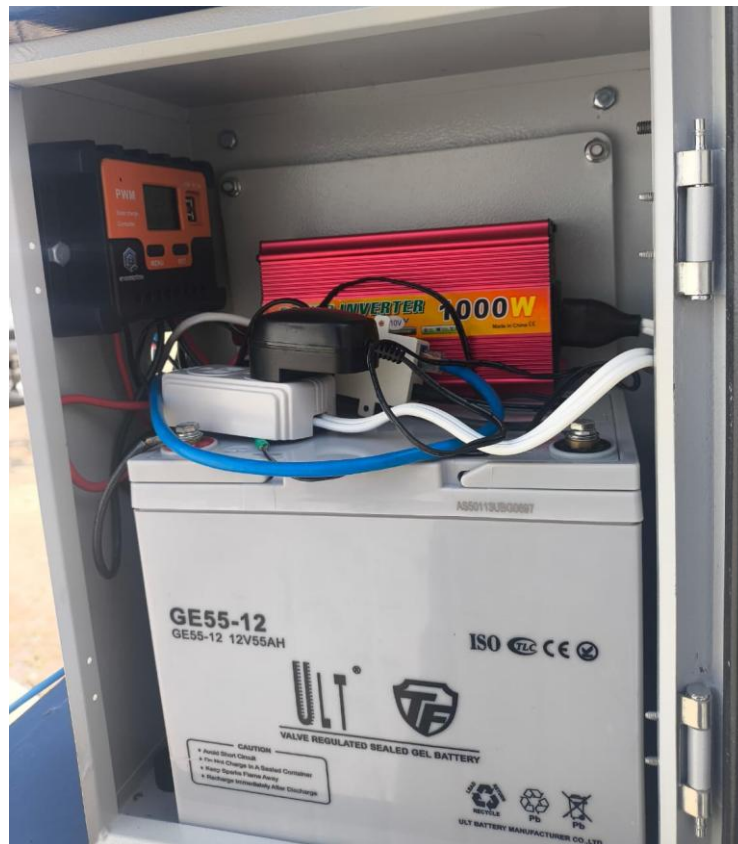
Figura 29: Compartimento de conexiones
