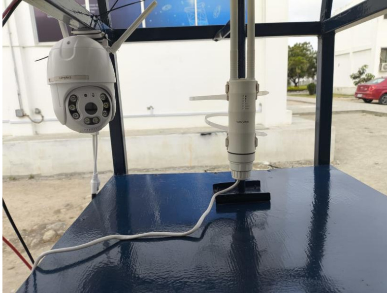
Figura 33: Conexión de la antena hacia el inversor
