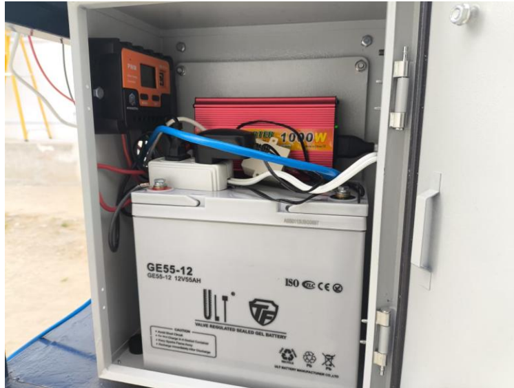
Figura 34: Extensión eléctrica múltiple conectada a la salida del inversor
