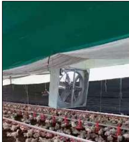
Anexo 38A. Sistema de ventilación del galpón.
