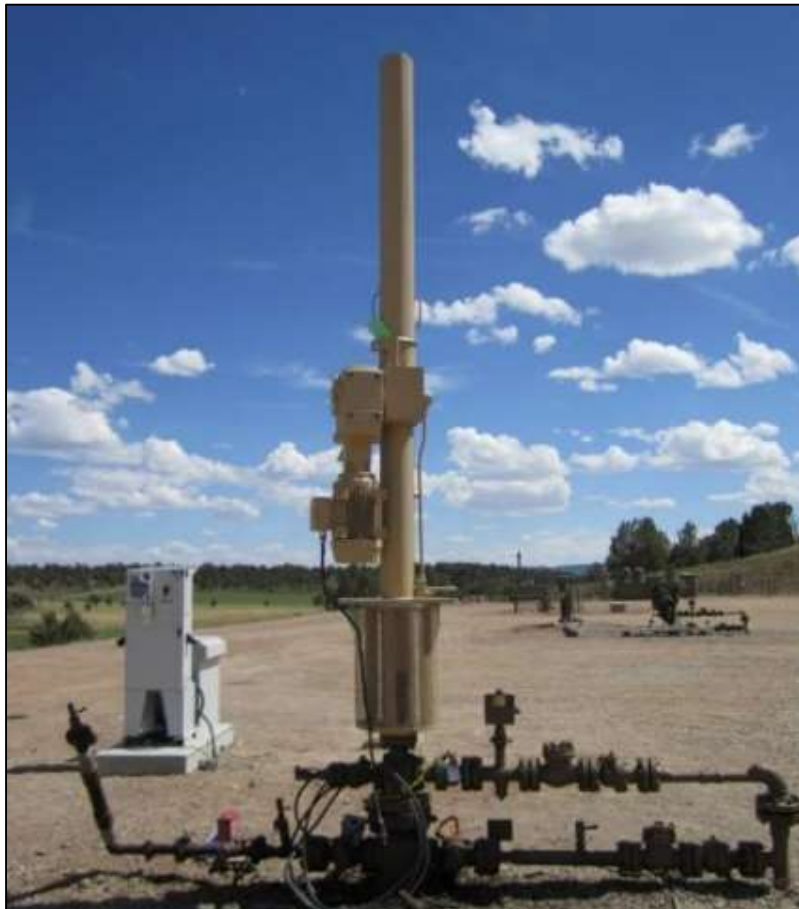
Figura 8. Sistema Linear Rod Pump instalado (Unico LLC, 2022).
