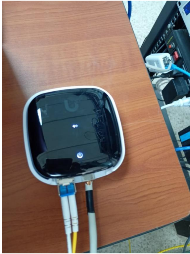
Figura 42. UDM Transmisión conectado a la media converter con SPF
