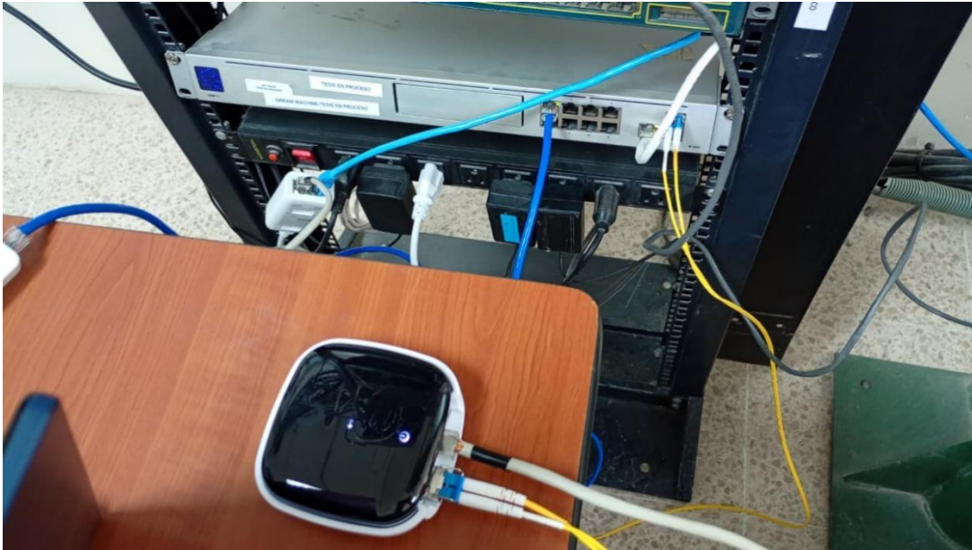
Figura 41. UDM CONECTADO AL MEDIA CONVERTER CON SPF
