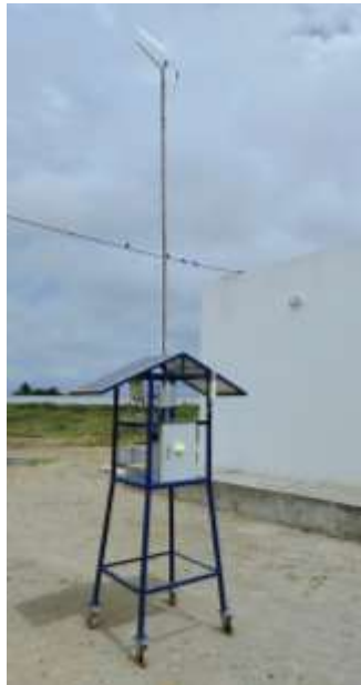
Figura 31. Estructura modificada para el uso del amplificador de cobertura celular alimentado por energía solar
