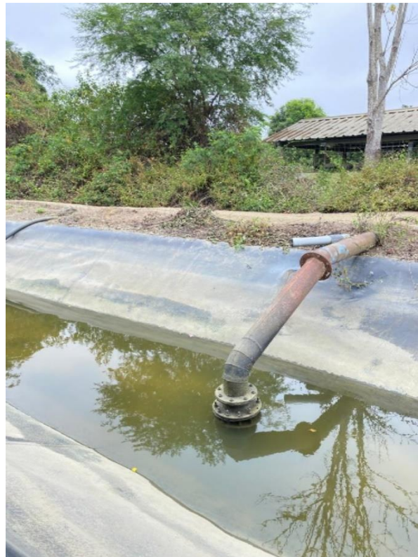
Anexo A.6. Fotografía de tubería de succión de sistema de bombeo en mal estado.
