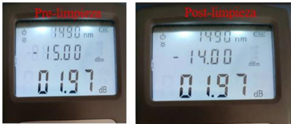
Figura 43 Medidas de potencia en la ONT en el Módulo Móvil Pre-Limpieza y Post-Limpieza
