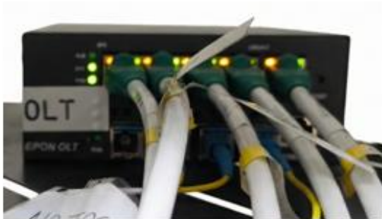
Terminal de Línea Óptica (OLT)
