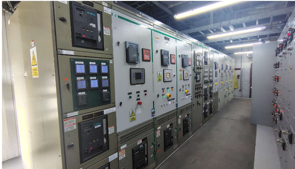
Anexo 3 Centro de control de motores MCC
