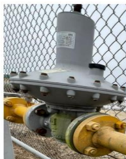
Ilustración 24 Reguladores de presión
