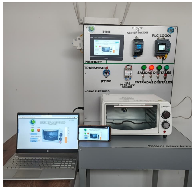
Figura 41: Encendido y Apagado del sistema. Fuente: Autor.
