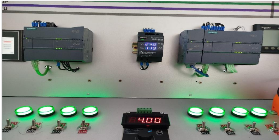
Fig. 17 Prueba de funcionamiento del protocolo Profinet
