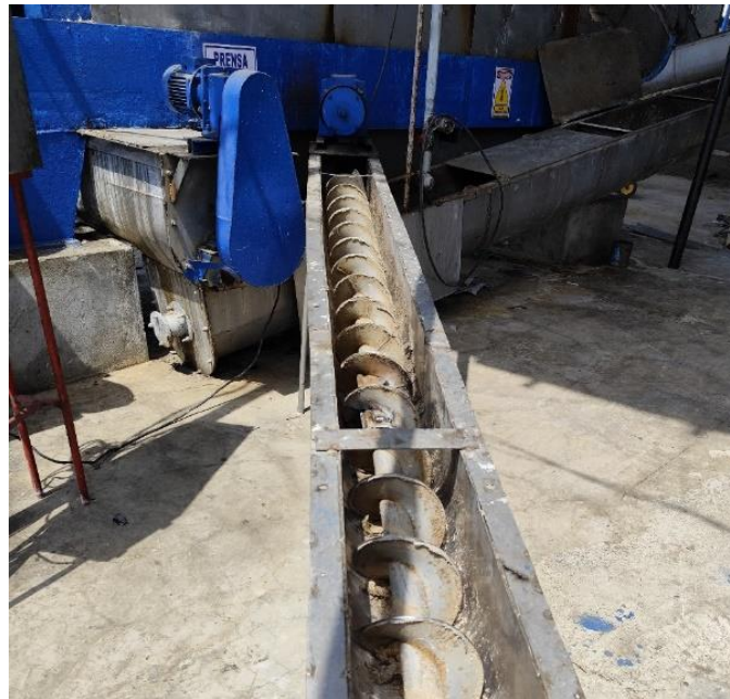
Nota: Transportador helicoidal antes de ser limpiado
