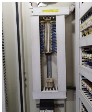
Figura 51. Panel de distribución eléctrica.
