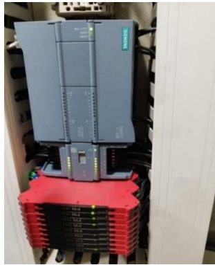
Figura 52. Conexión del PLC S7-1200 y los convertidores 3111. Realizado por: Adriana Castillo, 2023
