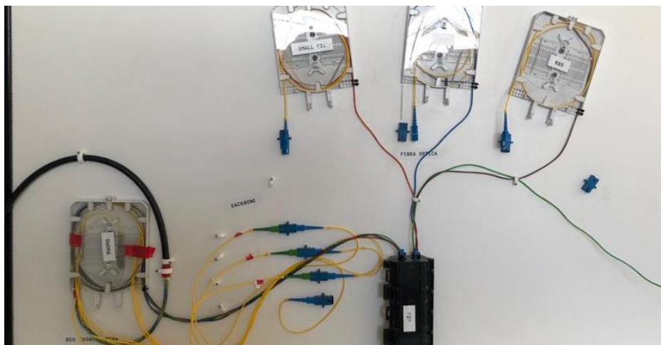
Figura 4.20. Análisis de estado del tablero MSAN
