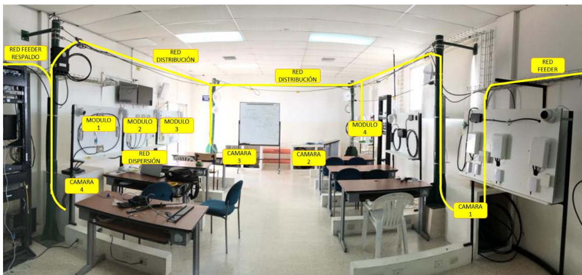
Figura 4.16. Distribución de cables de fibra óptica.
