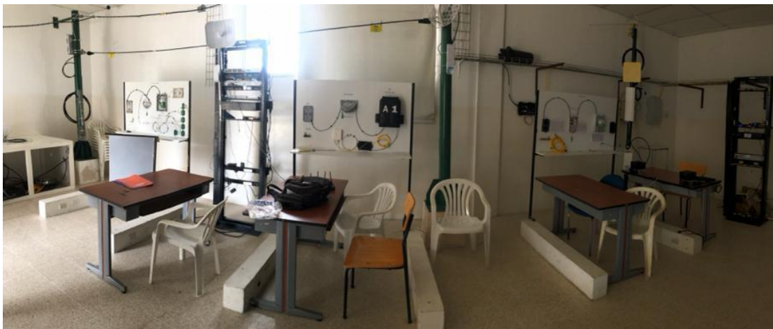
Figura 3.25. Distribución de fibra ADSS dentro del laboratorio.
