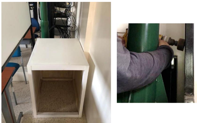
Figura 4.9. Ubicación e instalación de cámaras subterráneas 1 y 4
