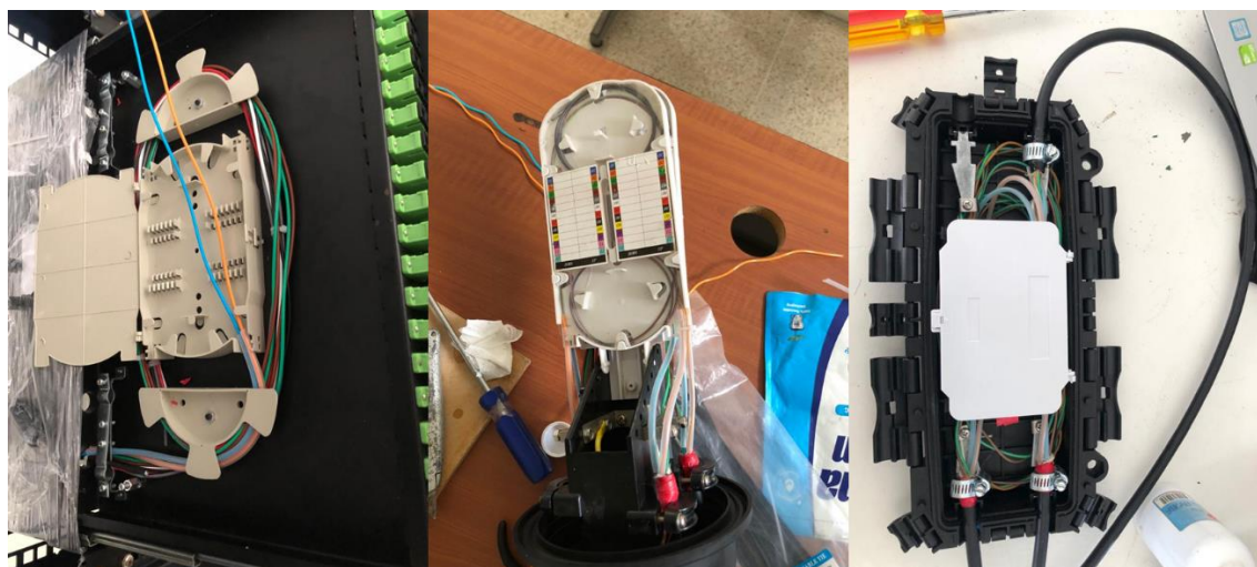
Figura 4.11. Instalación de fibra ADSS en el ODF y Mangas
