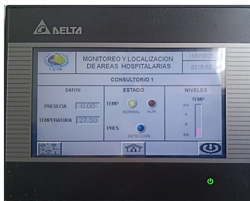
Figura 20: Llegada de Datos en el HMI
