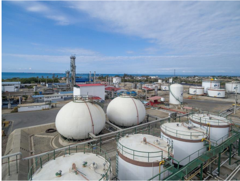
Gráfica 3. Tanques de almacenamiento de la RLL. (EPPetroecuador, s.f.).
