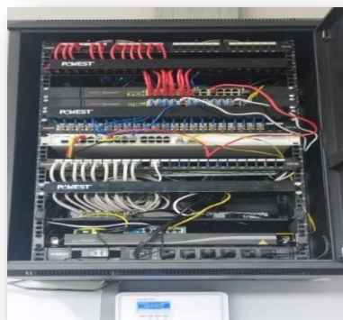
Figura 53. Rack con dispositivos Switch 1
