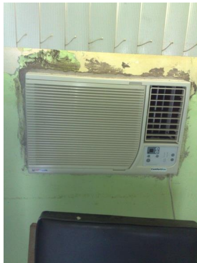
Oficina de Enfermería, mala ubicación del aire acondicionado. Aires acondicionados en mal estado.
