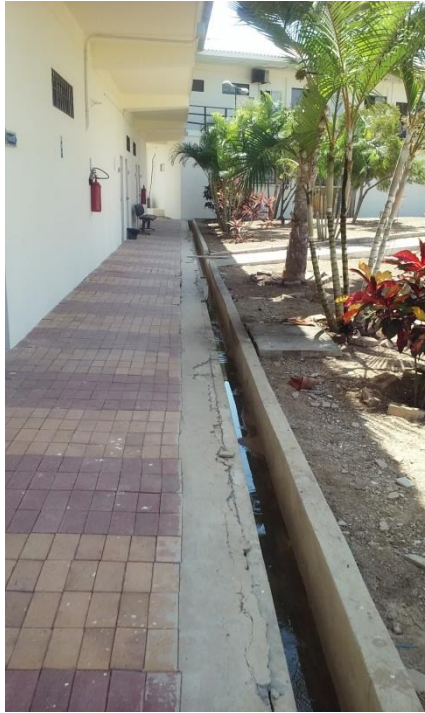
Pasillos del área administrativa, en mal estado, Tratamiento de aguas residuales del proceso de esterilización de Quirófano.
