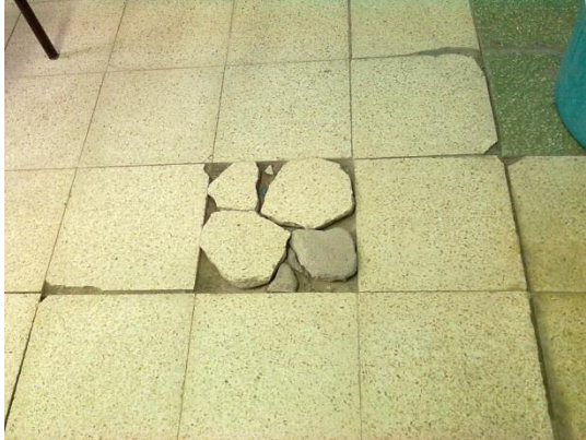
Piso de la Bodega General, en mal estado.
