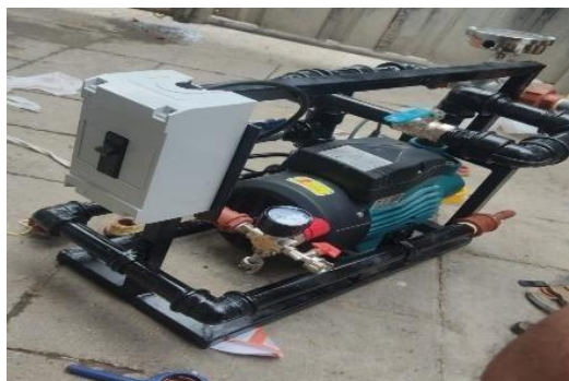
Figura 26: Implementación de la caja de control.
